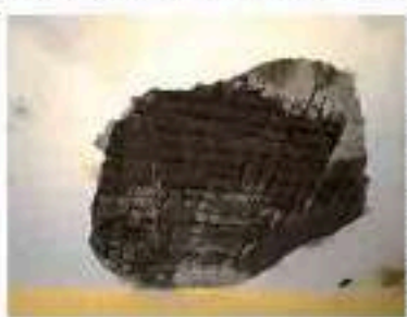
खारघर : रेल्वे स्थानकातील स्लॅबचे प्लास्टर कोसळून कर्मचारी जखमी झाला.
